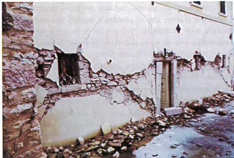
Figure 1-2-3 Lesioni a taglio al piano terra sui muri perimetrali di edificio ad Avendita di Cascia (PG)
