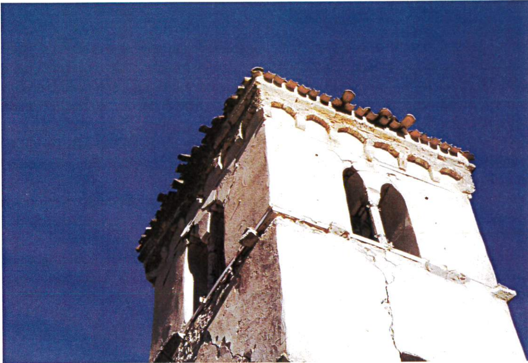
Figura 14 La cella del campanile di S. Martino dei Gualdesi, Castelsantangelo sul Nera (MC), con le due cerchiature metalliche, dopo i terremoti.
