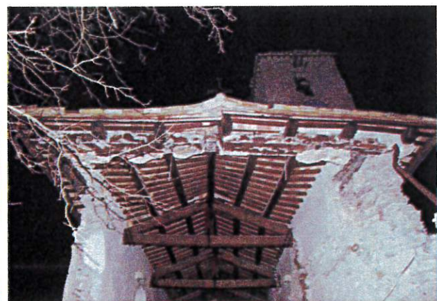
Figura 22 Chiesa di Norcia. Comportamento divaricante assunto dal cordolo sul timpano nel corso del crollo della facciata.
