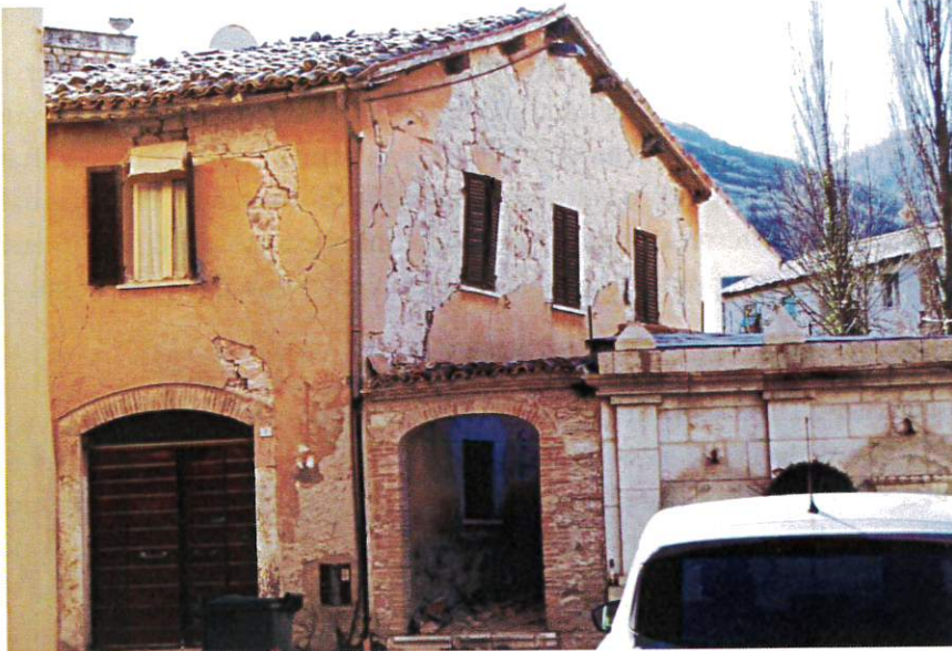
Figura 9 Edificio rintonacato senza intervento sui giunti murari, e manifesta comportamento disgregativo. Visso (MC)
